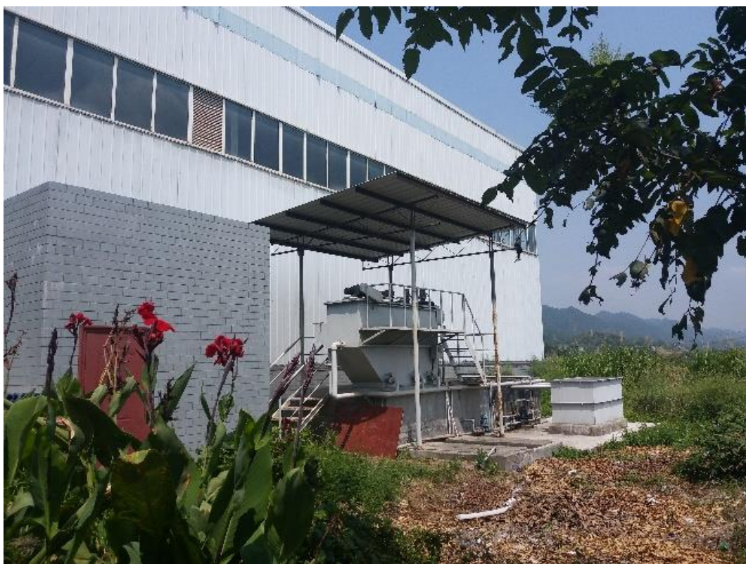
图 3 生产废水处理站
