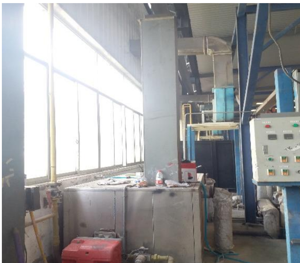
图 2 天然气锅炉排气筒
